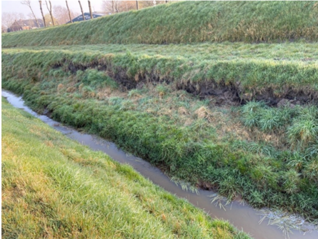
Figuur 2: Schade aan sloottalud bij de Borgsloot als gevolg van slechte microstabiliteit binnenwaarts. Vond plaats tijdens hoogwater in 2022.
