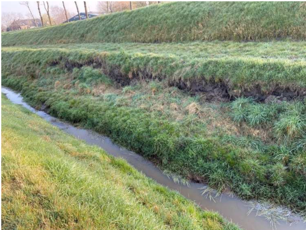
Figuur 1 Verzakking in de buurt van gemaal Borg
