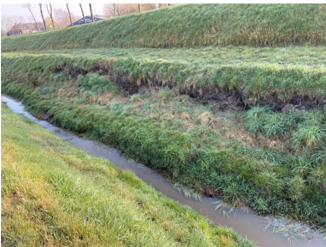
Figuur 1 Verzakking in de buurt van gemaal De Borg
