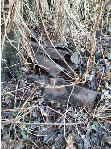
1. Asbestplaten op het maaiveld (perceel Middelberterweg 5) - 16 januari 2023
