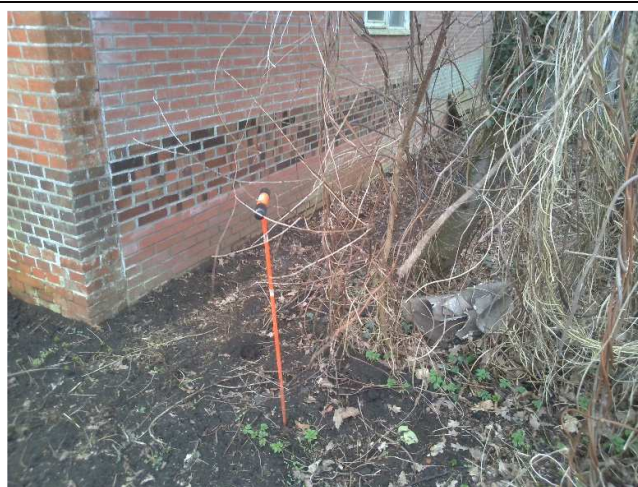
8. Asbestverdachte golfplaten ten noorden van de woning (vanuit het noordoosten)
