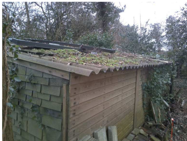
6. Schuurtje met asbestverdachte golfplaten als dakbedekking (vanuit het noordoosten)
