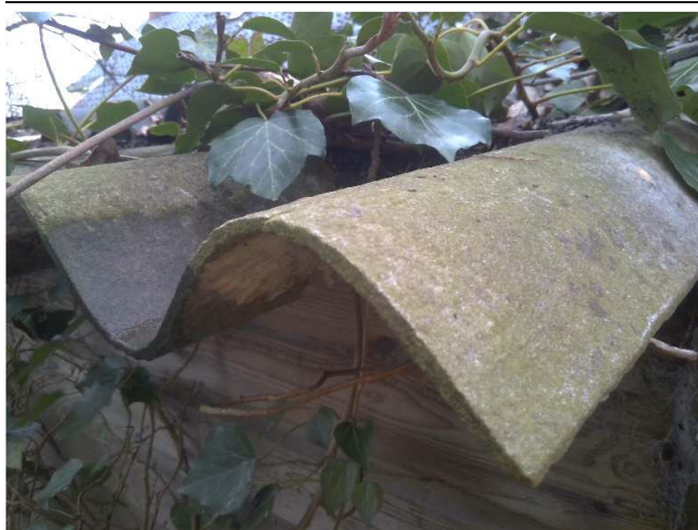
7. asbestverdachte golfplaten op het schuurtje
