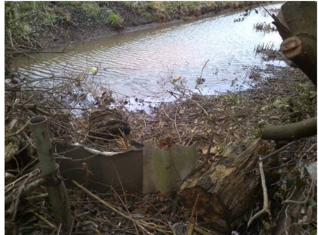
2. Asbestverdachte beschoeiing (vanuit het noordoosten)
