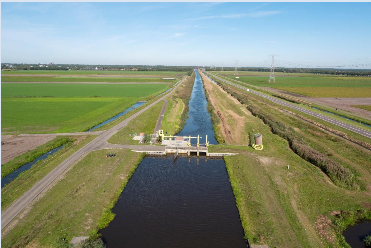
Afbeelding 5.1. Aanvoergemaal Vennix in het A.G. Wildervanckkanaal.
