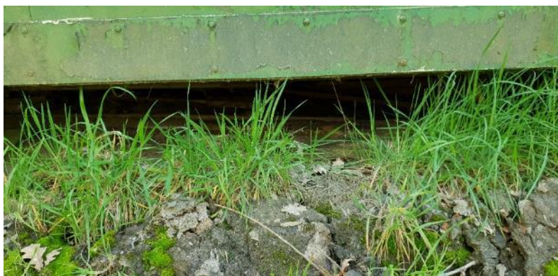
Figuur 4-1: Open ruimte onder de aanwezige keet in het plangebied (foto RHDHV).
