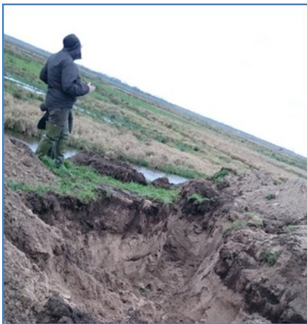
Schade door een vos (uitgegraven om te kunnen repareren)
